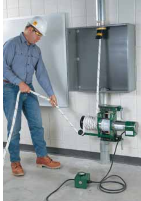
Вытягивания кабеля вниз с помощью устройства на платформе, прикрепленной цепями к трубопроводу.
