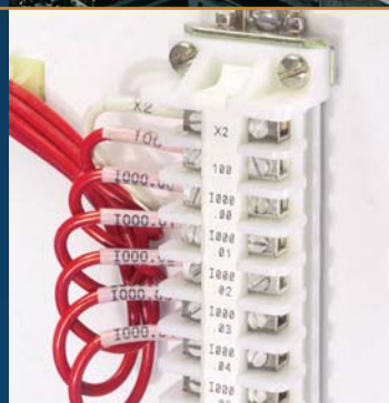
Маркировка терминальных блоков
